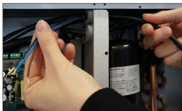
6. Faites passer le câble du capteur de CO 2 au travers de la conduite de câble jusqu'à la carte électronique. Puis, raccordez le câblage au boîtier d'alimentation.
