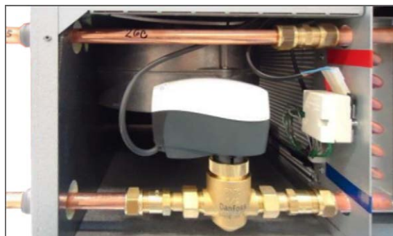
4. Le thermostat antigel (B3) est installé sur l'élément de post-chauffage de l'eau.
